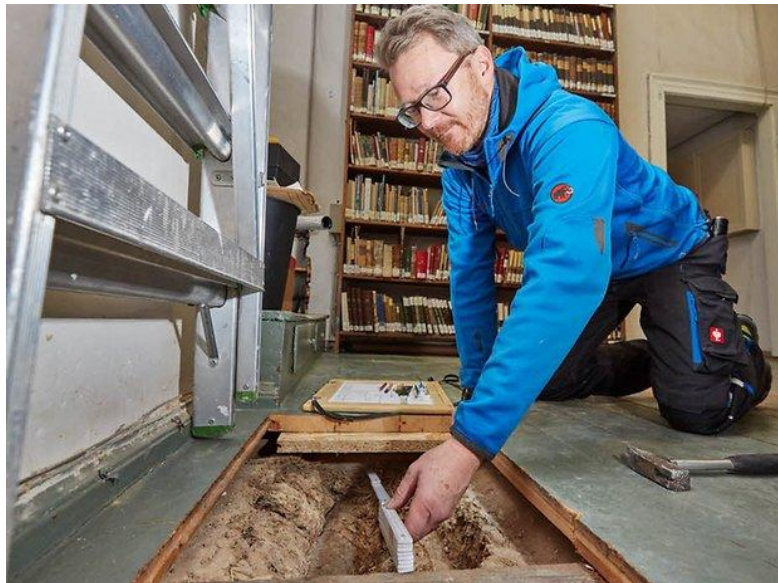
Bauingenieur Thomas Falz untersucht derzeit Balken und Lehmwickel im Museum Schloss Bernburg. Foto: Engelbert Püllicher
